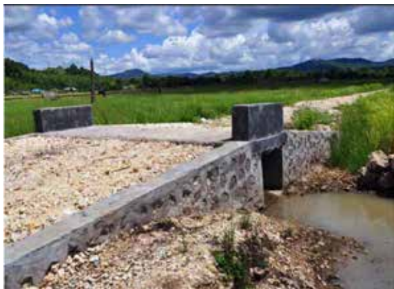
Jembatan dan Saluran Drainase
